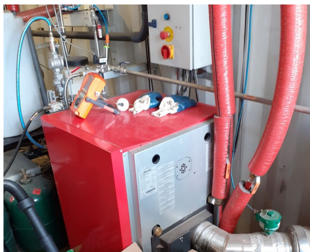
Brûleur du biogaz
