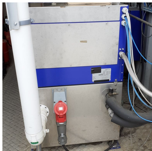
Générateur utilisant le biogaz
