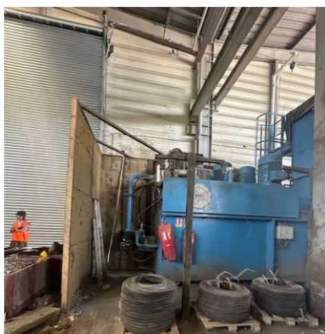
Vue sur le capotage des moteurs
