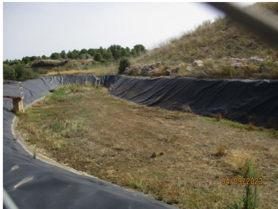
Bassin de collecte des eaux pluviales
