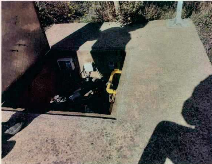
Bassin et vannes/pompes relevage
