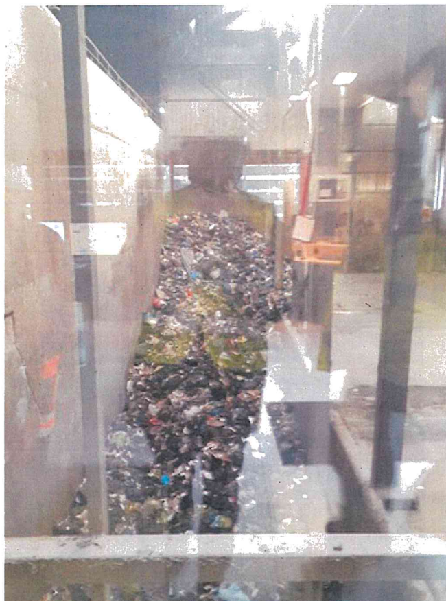
Fosse de réception des OMR
