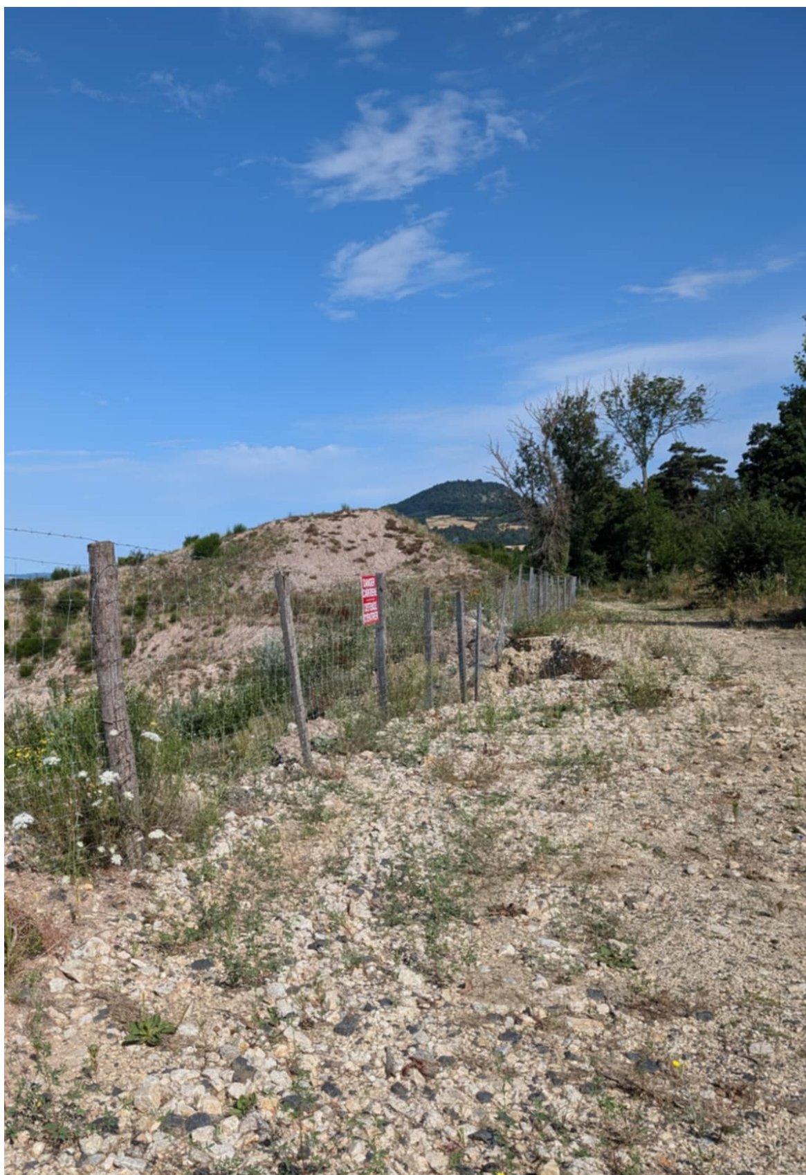
Affaissement du terrain en haut de la carrière de granite
