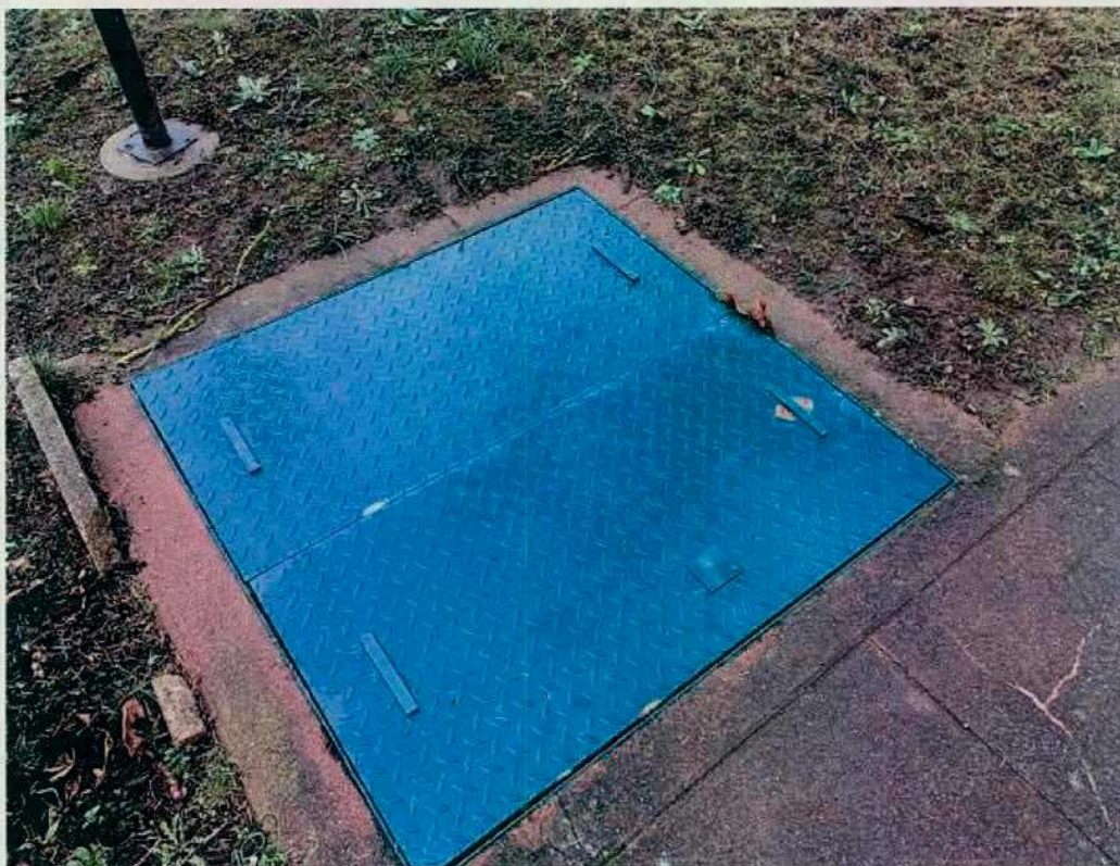
PLAQUE ACCÈS VANNE DE BARRAGE
