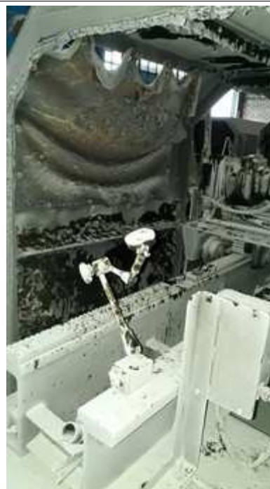
Intérieur calciné et dépôts d'extinction
