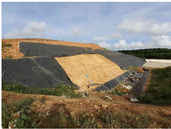
Illustration 6 : talus à l'Est du casier 4.5 avec envol de sa géomembrane (photo de l'inspection)
