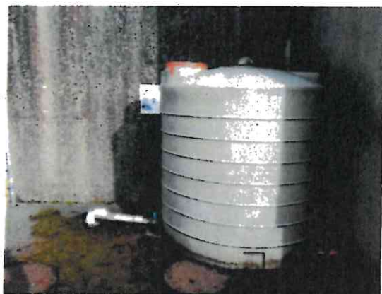
Citerne étanche de stockage de eaux collectées dans les silos couverts
