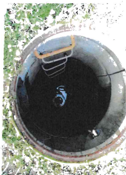
Regard d'accès à la vanne pour commande manuelle
