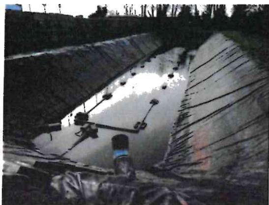
Bassin de confinement quasi-vide
