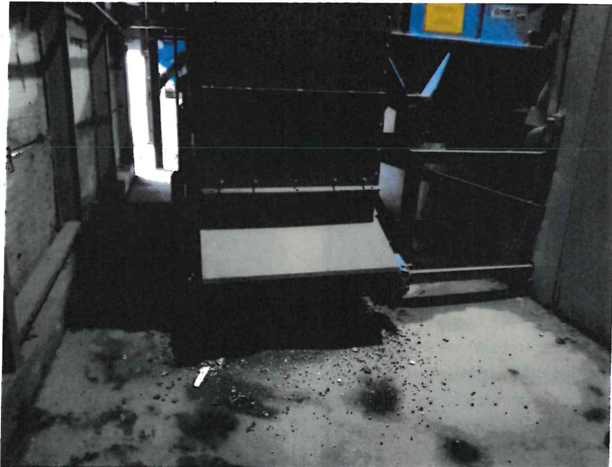
Vue intérieure du local du démanteleur QZ
