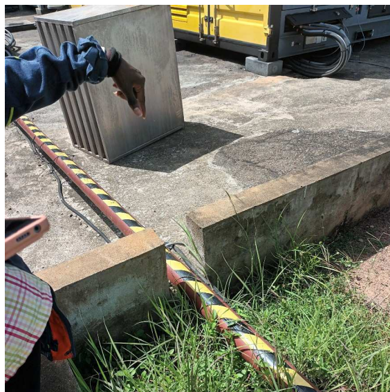
Passage de la canalisation impactant la capacité de la rétention
