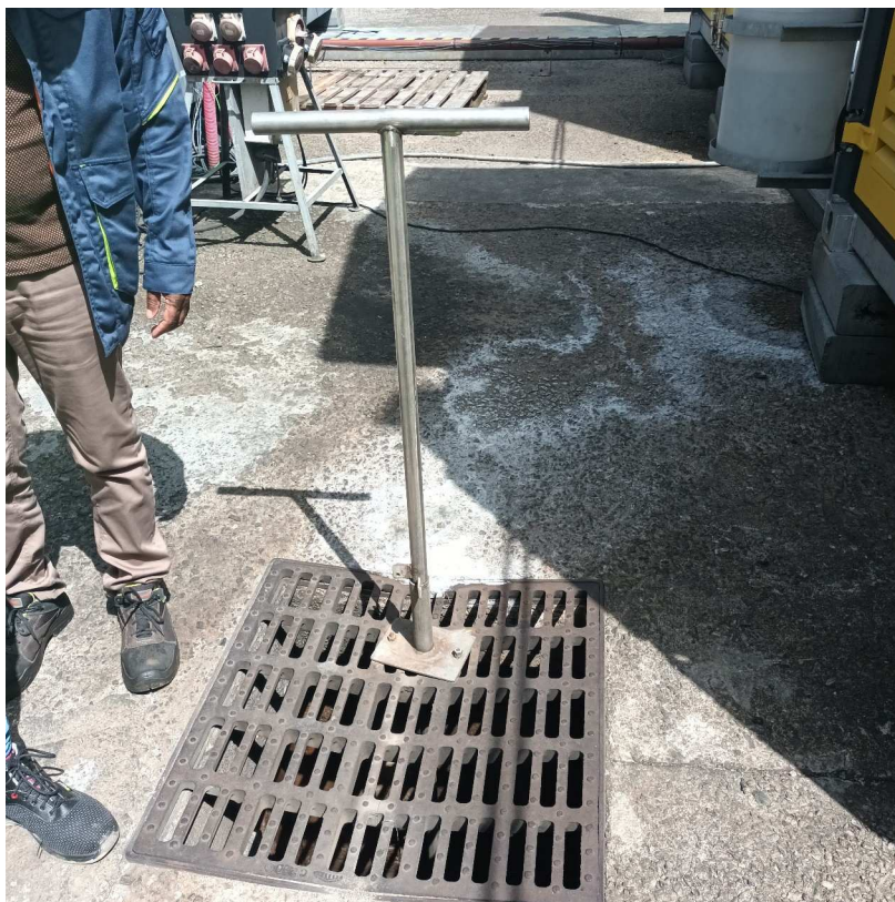
Vanne d'évacuation vers le milieu naturel
