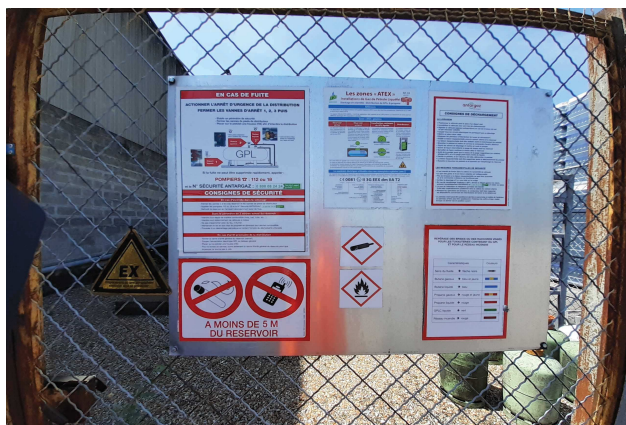
Zone ATEX – déchargement GPL (détail marquage)
