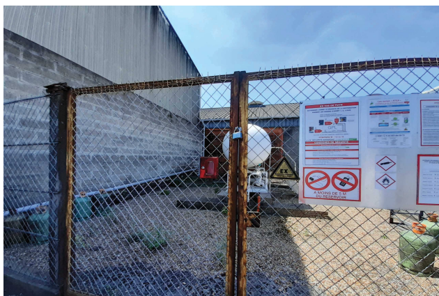
Zone ATEX – déchargement GPL
