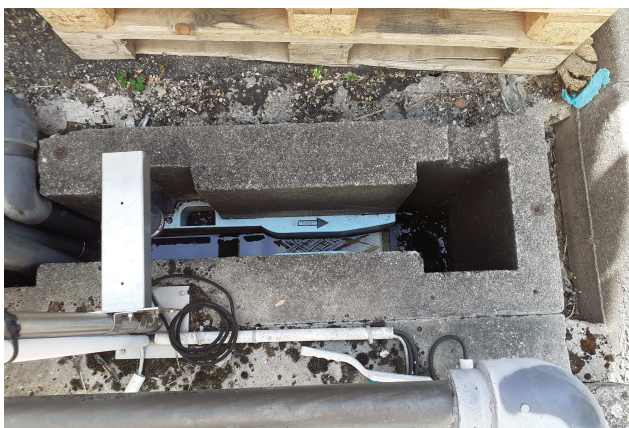
Point de rejet : eaux usées
