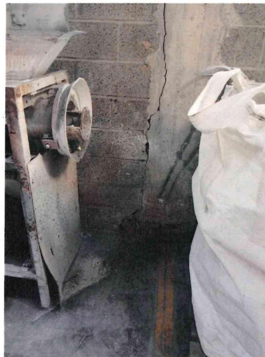
Fissure apparente n°1 sous bâtiment
