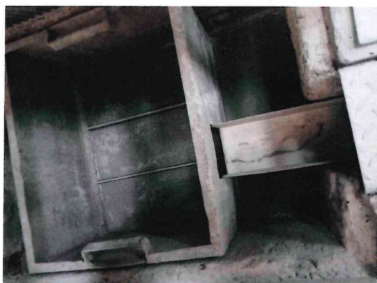
Dispositif en sortie d'installation
