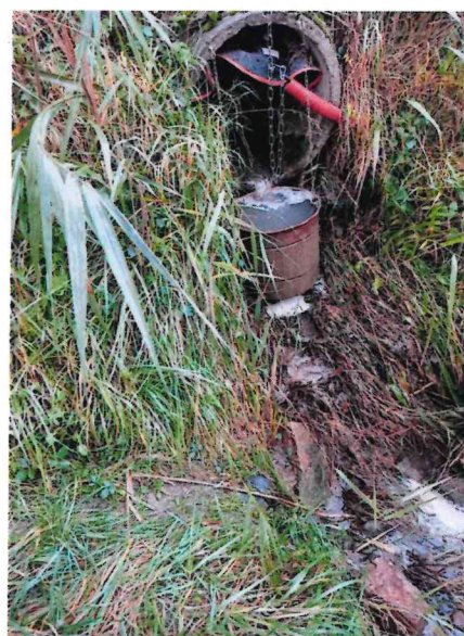
Dispositif en sortie du réseau d'eau
