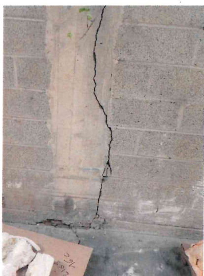
Fissure apparente n°2 sous bâtiment
