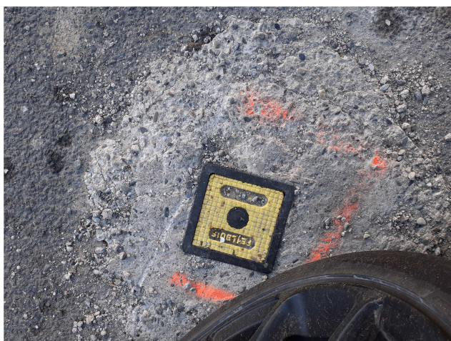
Piézomètre en amont
