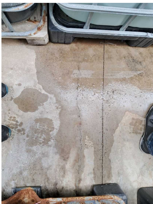
Fissure sur la dalle de la zone extérieure Nord-Ouest
