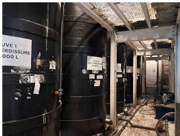
Étiquetage incomplet (cuves intérieures) et rétention non vidée
