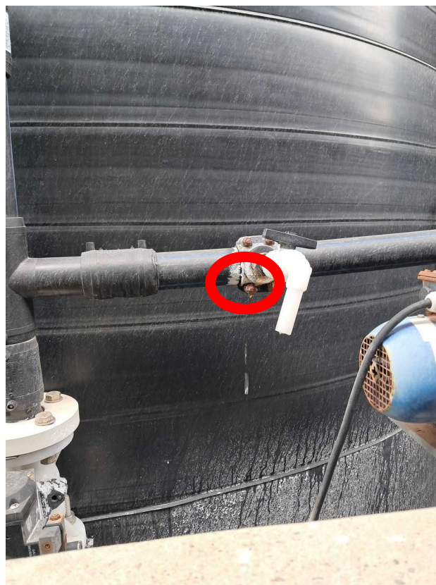
Fuite dans la rétention
