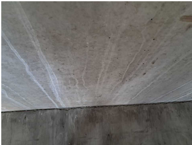
Zone non jointée sur le périmètre interne du bâtiment « produits finis »
