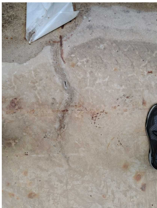
Autre fissure sur la dalle de la zone extérieure Nord-Ouest
