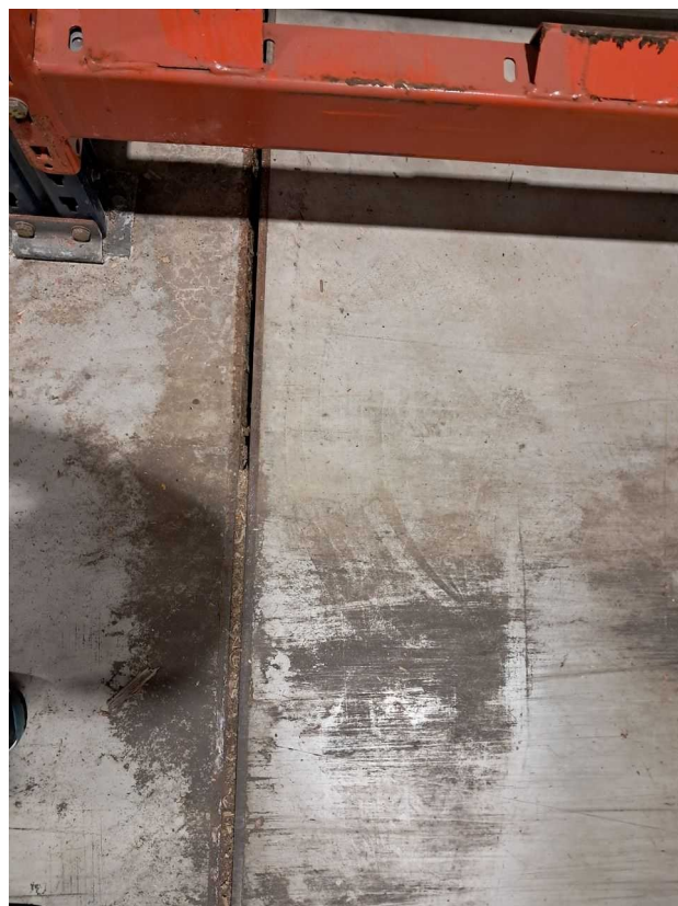
Joint de dilatation de la dalle non réalisé
