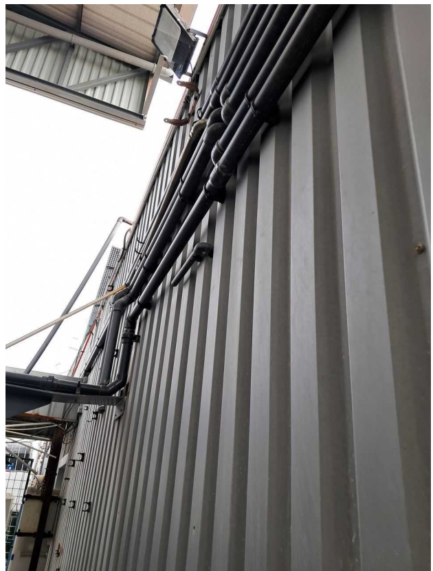
Fuite hors rétention sur sol peu imperméable
