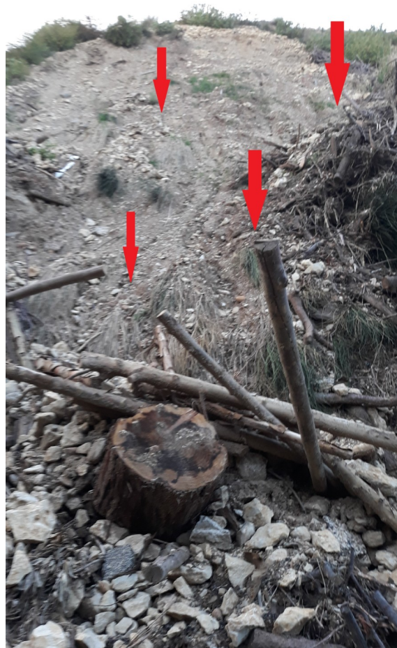
Figure 5: Glissement de matériau, présence de souches, troncs; Vue du bas du talus au niveau du lit asséché de la rivière
