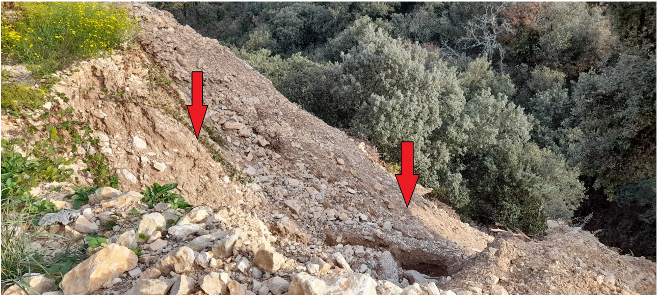
Figure 3: Glissement de matériau : Vue du haut du talus
