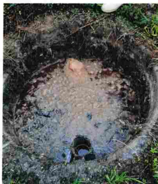
Puisard sans dégrilleur de 6 mm avec de nombreux déchets grossiers flottants
