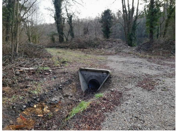
végétation dans fossé d'eaux pluviales
