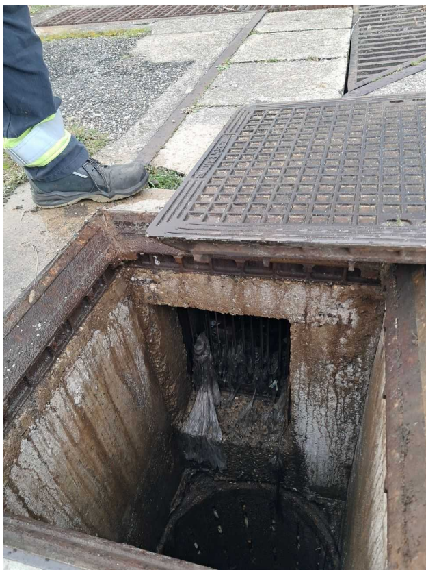
Puits d'infiltration/puits perdus ? et grille remplie de déchets plastiques
