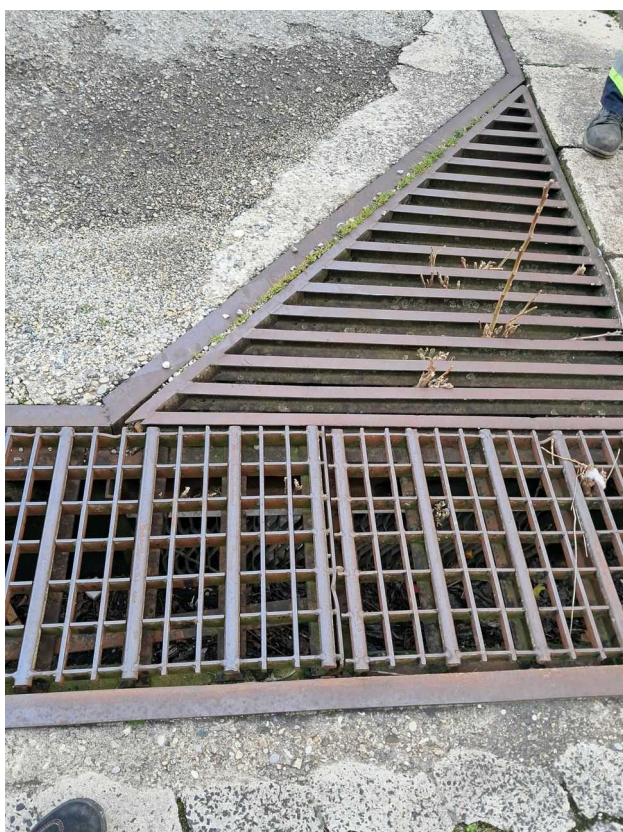
Fin Sud de l'avaloir de la zone Sud-Est
