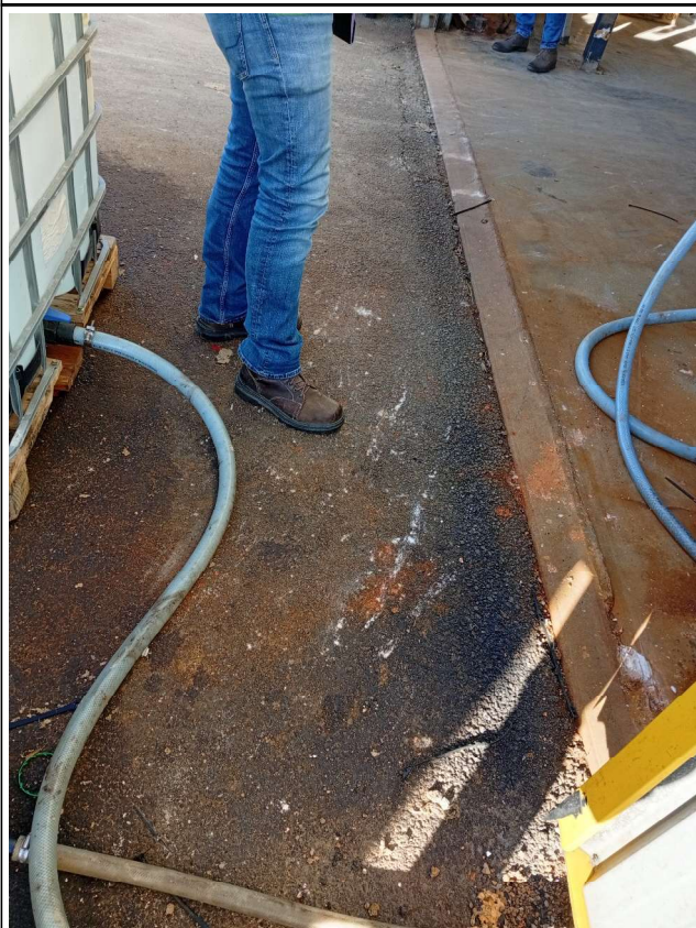
Traces de couleur cuivrée, témoin du rejet d'une fuite de sulfate de fer, au moyen d'une raclette, à l'extérieur du bâtiment dédié au conditionnement des produits (3/3)
