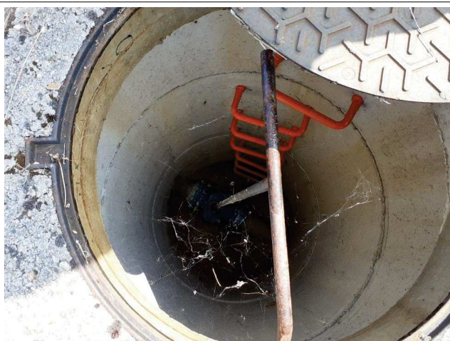
Vanne fermée du tuyau entre bassins
