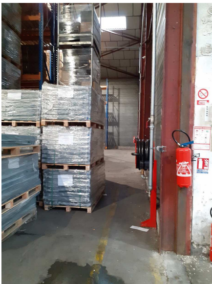
Photo 9 : accès aux RIA dégagé
