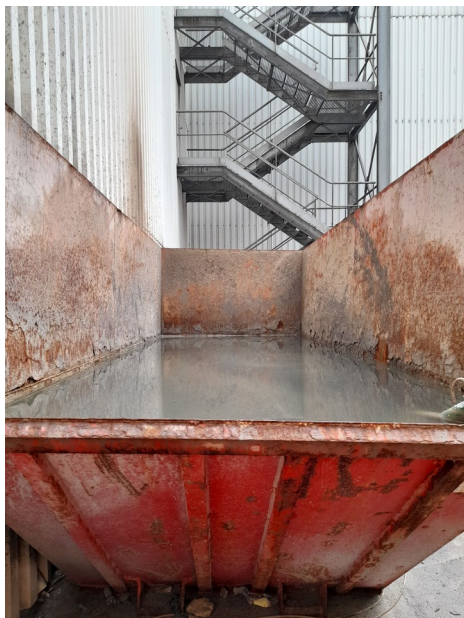
Benne de récupération des boues du décanteur entièrement pleine le jour de l'inspection
