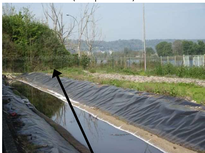
Dispositif de traitement des eaux pluviales existant (bassin tampon + séparateur à hydrocarbures)
