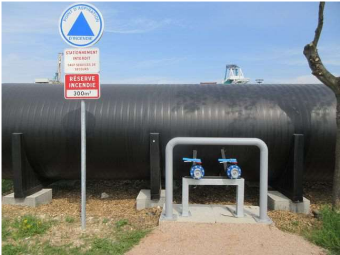
Réserve incendie de 300 m 3
