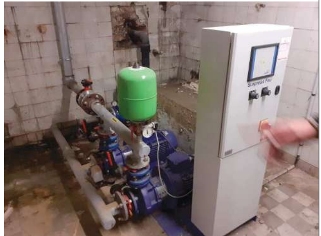
Photo 4 - Local surpresseur -2 pompes RIA
