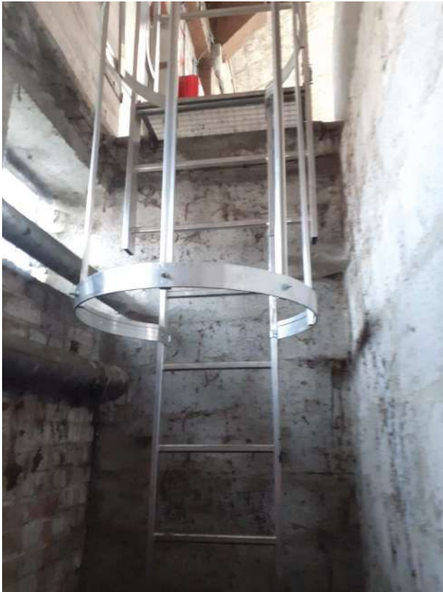
Photo 3 : échelle à crinoline faisant office d'issue de secours-sous-sol bâtiment B1
