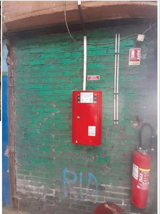
Photo 12: commande de désenfumage
