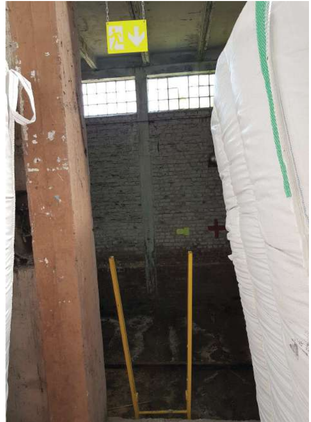
Photo 4 : Issue de secours bâtiment B2- échelle donnant vers la voie ferrée
