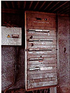
Photo N°11 : Sciure sur armoire électrique
