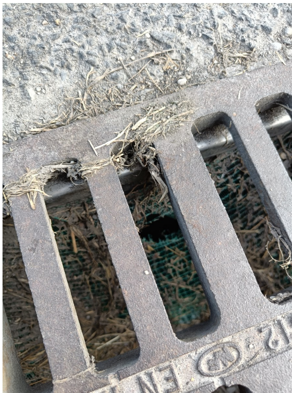
Exemple de filet de confinement des GPI déchiré sur un avaloir d'eaux pluviales
