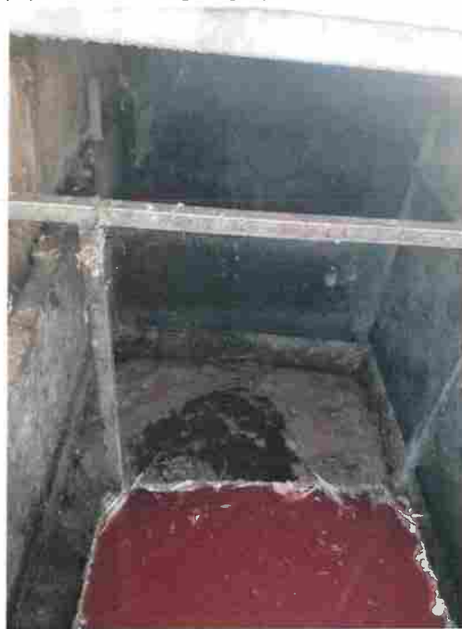
Équipements du dégrillage (panier et grille < 6 mm)
