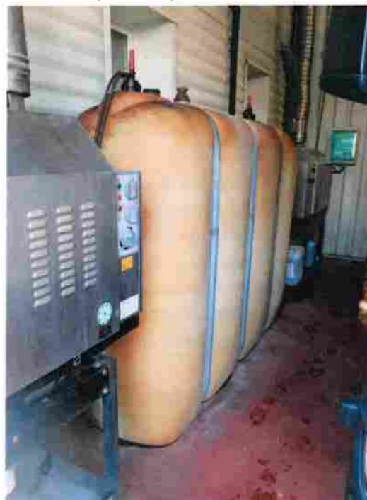
Cuve à fioul (simple ou double paroi ?)
