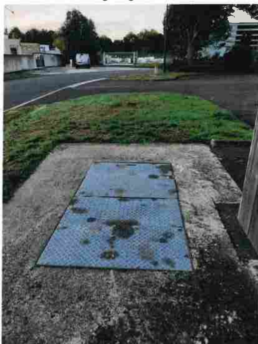
Poste de dégrillage des eaux usées
