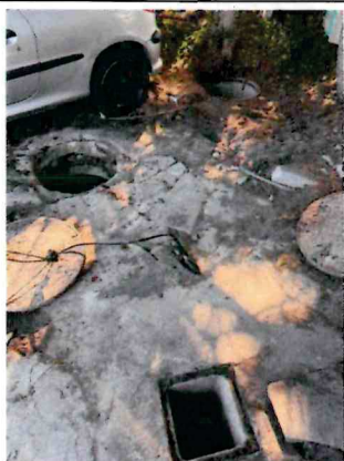
Zone séparateur hydrocarbure
