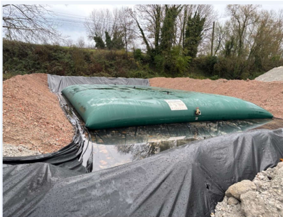
Rétention de la cuve souple contenant des effluents chargés en PFAS
