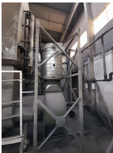
Configuration du rejet atmosphérique de la cabine de sablage après épuration des émissions
