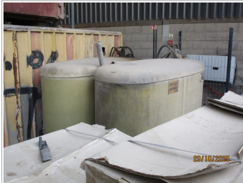
Cuve de stockage des huiles minérales et liquide de refroidissement usagés
