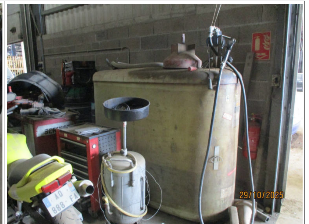
Cuve de stockage du gazole non routier pour les engins évoluant sur le site
