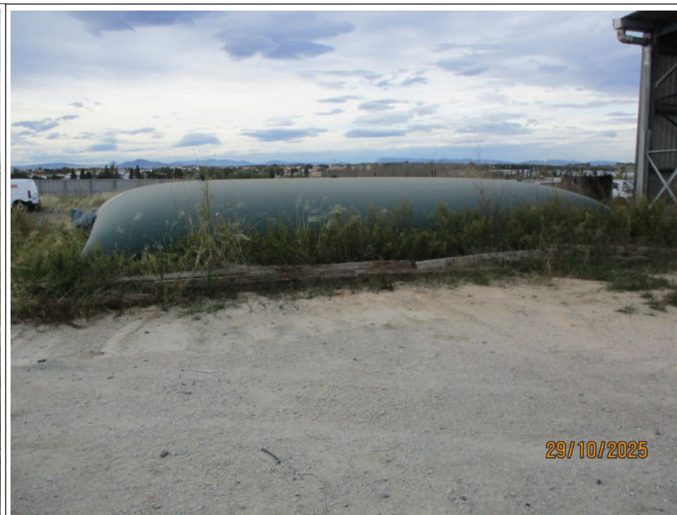
Citerne incendie souple (situé côté Ouest de l'établissement)
