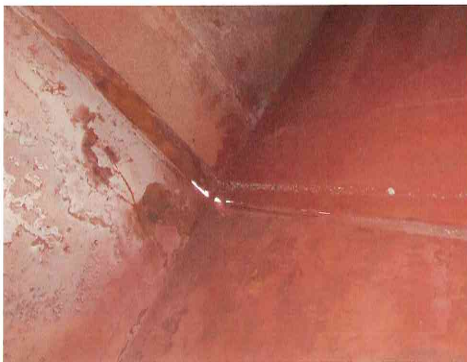
Carneau de fumée
