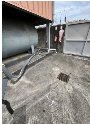
Cuve de fioul et zone de dépotage avec point bas raccordé au séparateur d'hydrocarbures
