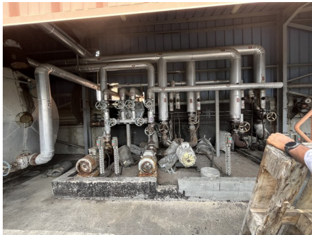
Circuit de chauffage à huile thermique sur rétention
