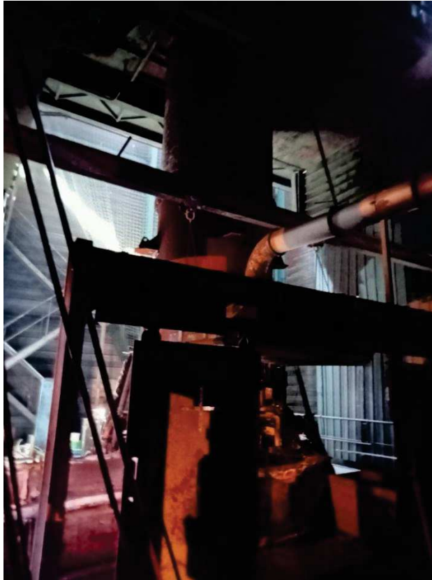
Conduit du four de fusion Asarco
