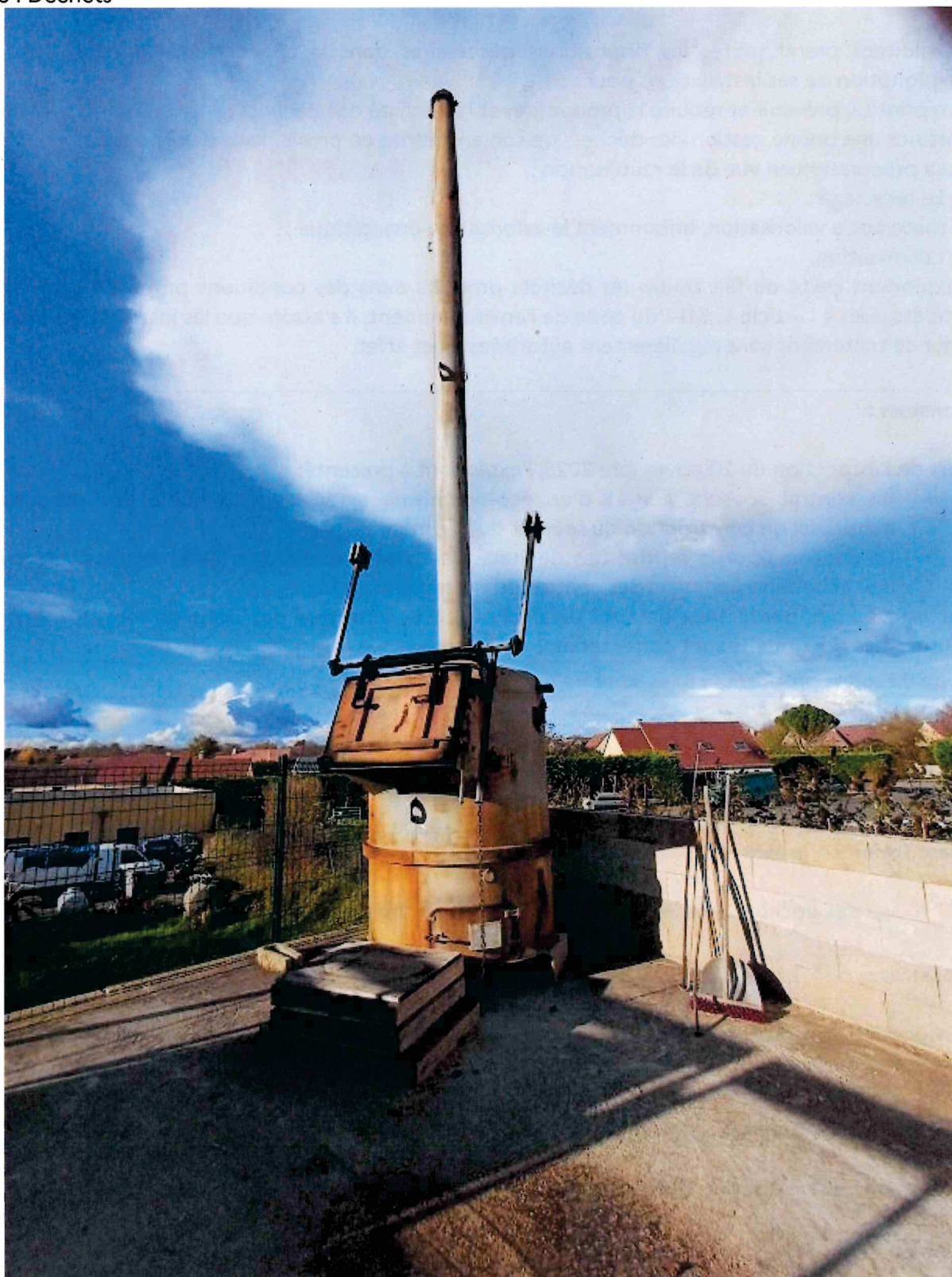
Équipement de brûlage
