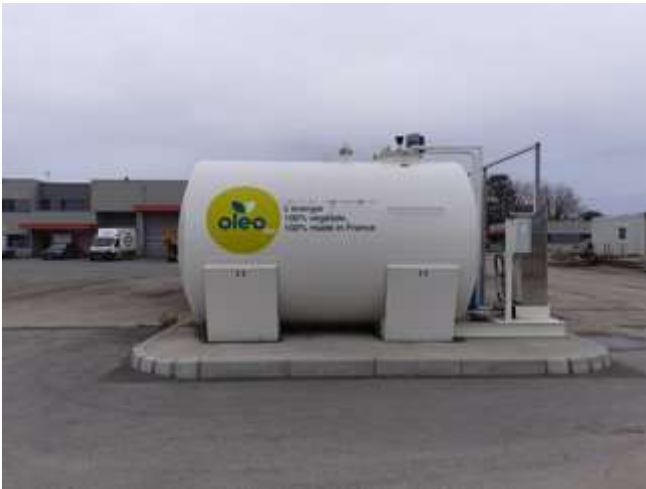
Réservoir double enveloppe
