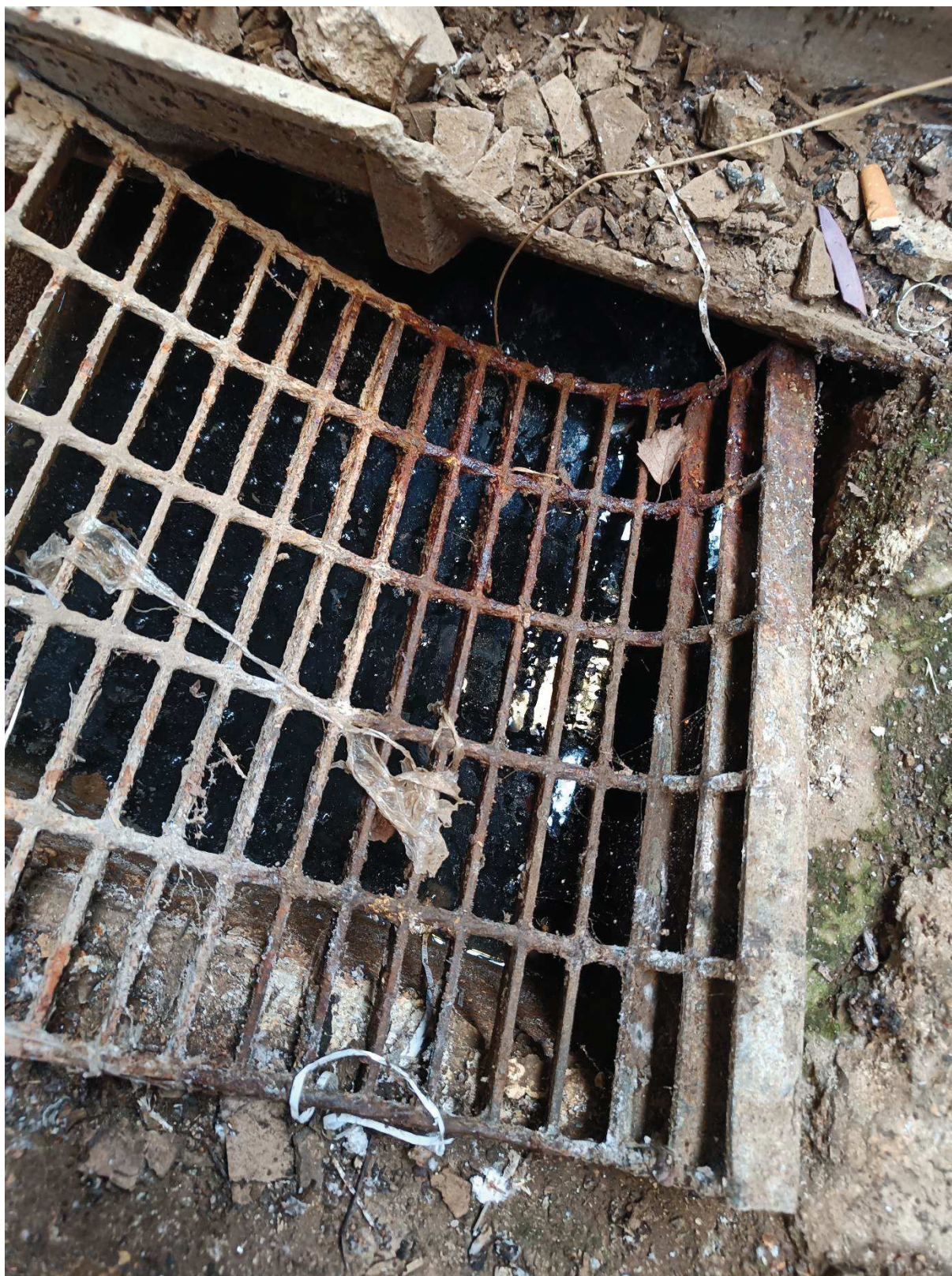
Figure 8 : Liquide brunâtre non identifié dans le réseau d'évacuation des eaux
