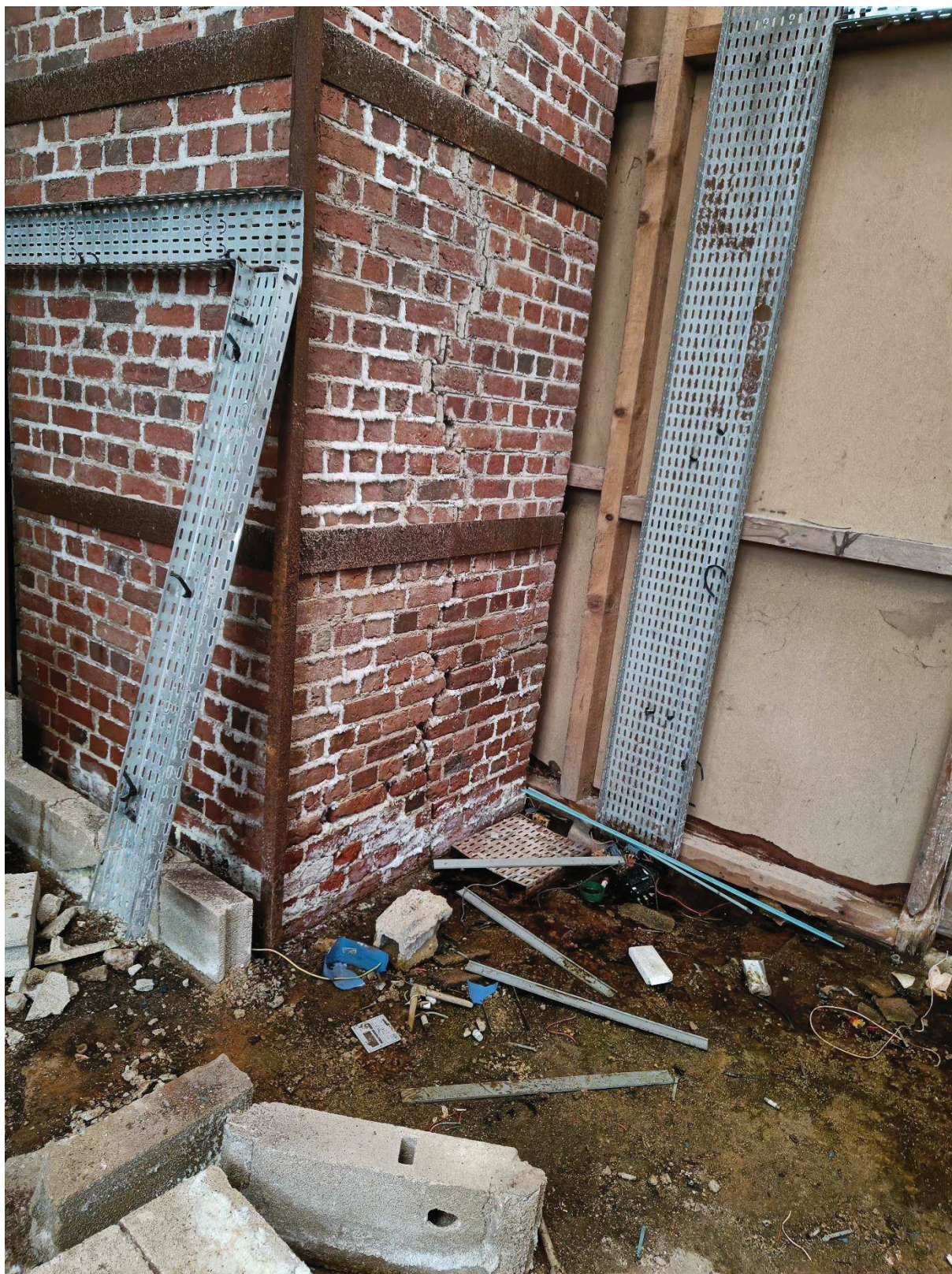
Figure 9: Emplacement de deux armoires électriques disparues
