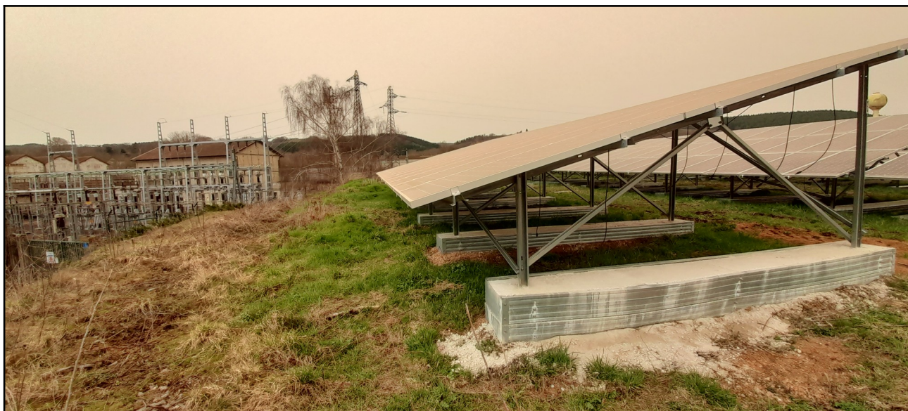
Vue n°3 : Structure et module photovoltaïque en zone grevée de servitudes 2B
