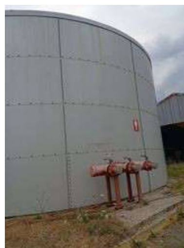
Réserve incendie reconstituée au 3/4 lors du contrôle
