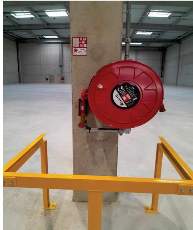
Photo 6 : un RIA dans la cellule 2 :
