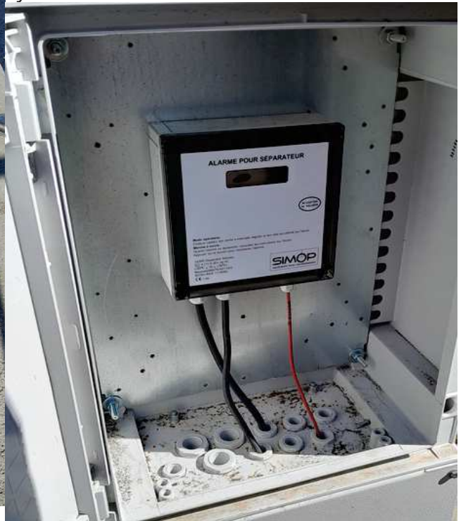
Photo 12 : boîtier alarme séparateur hydrocarbures
