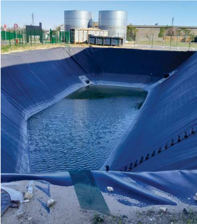
Photo 9 : bassin de confinement étanche :
