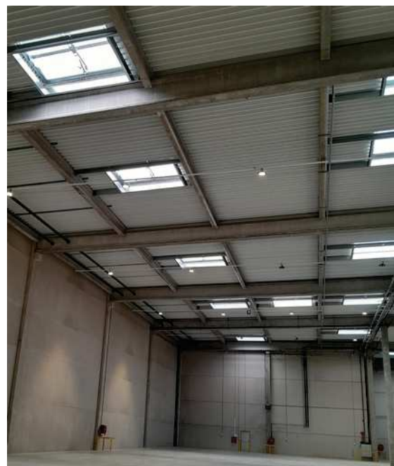
Photo 8 : exutoires en partie haute du bâtiment :
