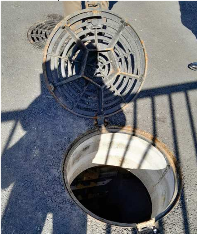
Photo 11 : tampon accès massif drainant :
