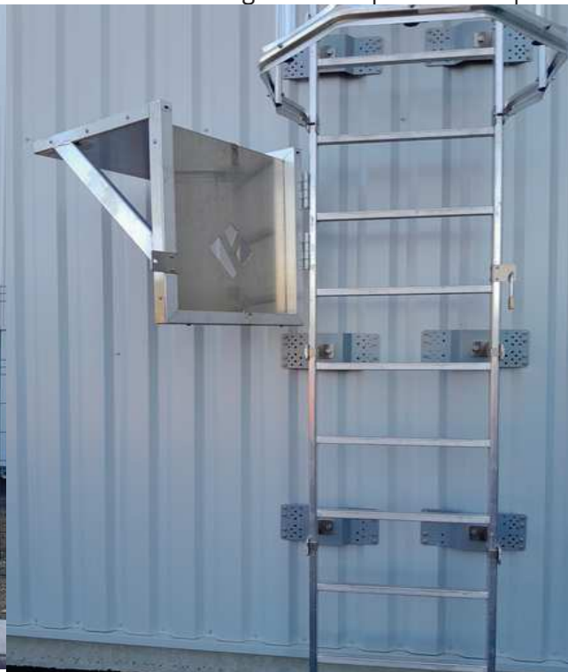
Photo 14 : absence signalisation photovoltaïque
