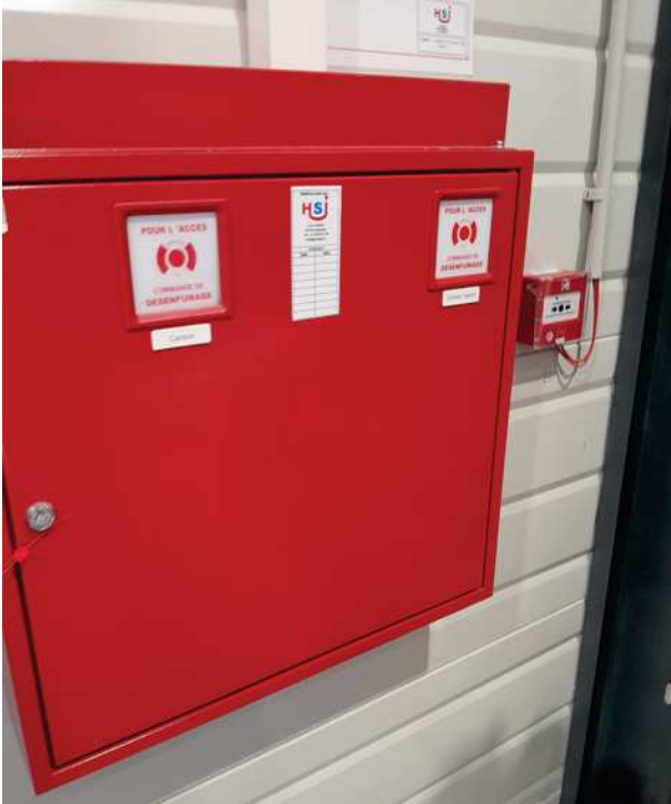
Photo 5 : Boîtier de déclenchement alarme incendie (à droite) et commandes du système de désenfumage (à gauche) :
