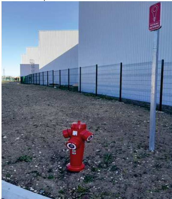
Photo 7 : 1 poteau incendie, non numéroté :
