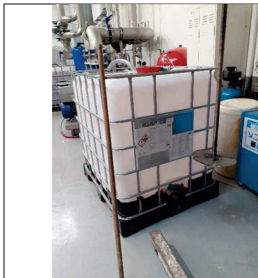
Glycol sans rétention Local refroidisseur SV4 Le 26/11/24
