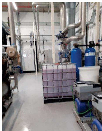
Glycol sans rétention Local refroidisseur SV4 Le 26/11/24
