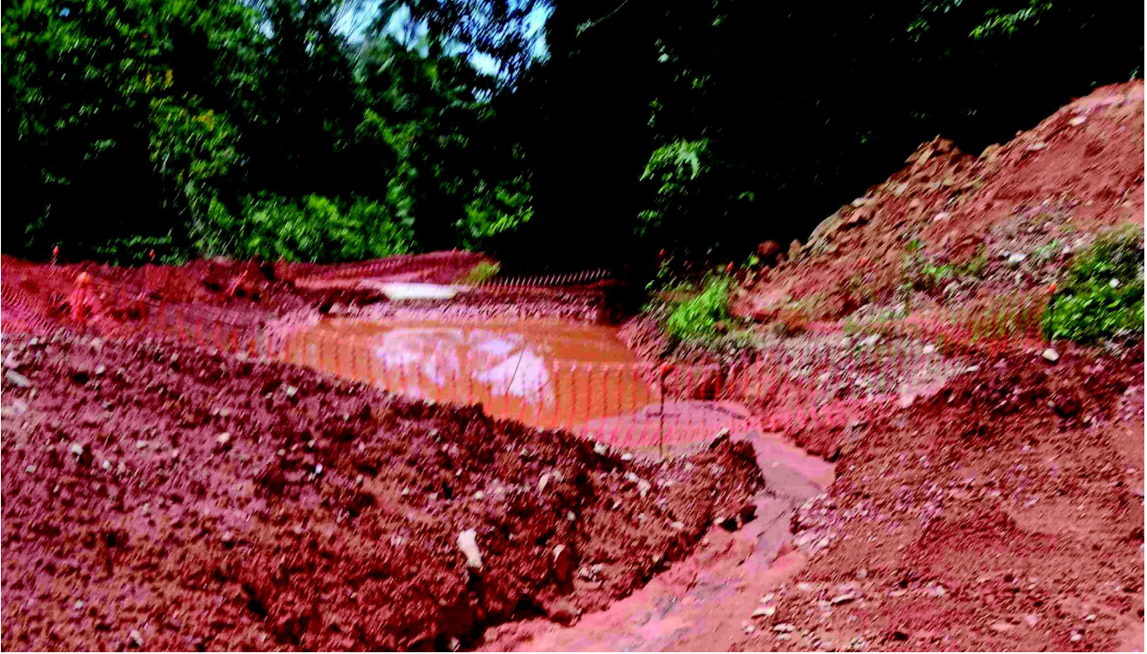
Chenal et bassin de décantation eaux pluviales
