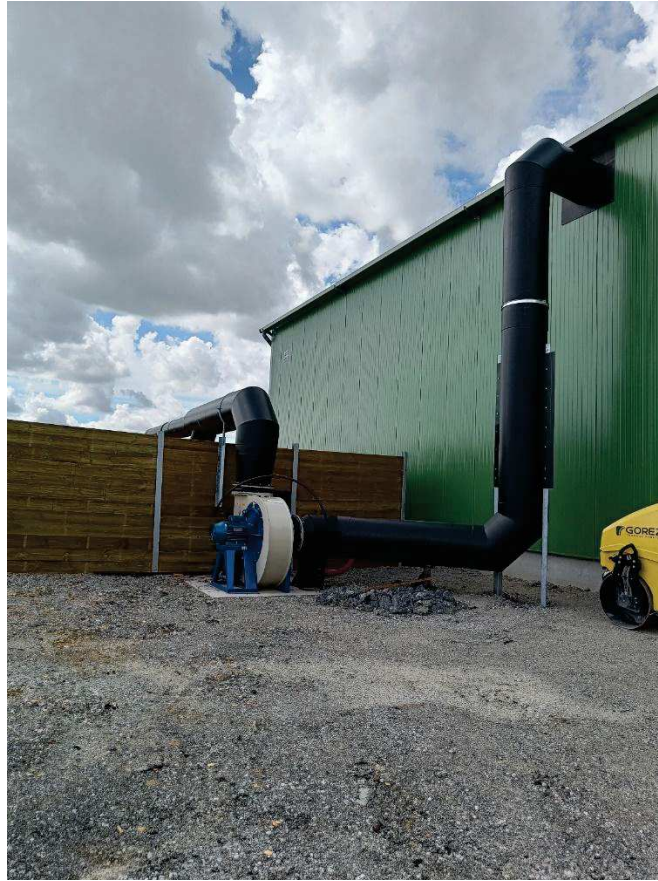
Figure 6 : Ventilateur d'aspiration des odeurs
