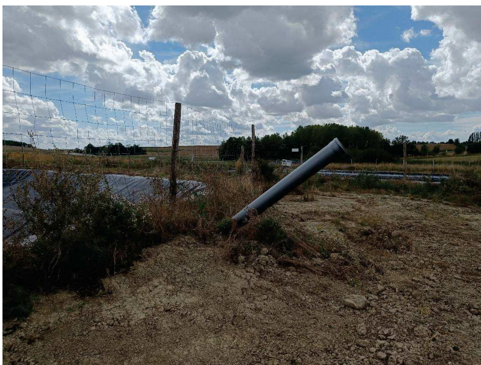
Figure 11 : Canalisation d'accès aux drains présents sous la membrane de la lagune de 2 000 m 3
