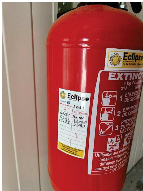
Figure 5 : Par échantillonnage - l'extincteur a bien été contrôlé en 2024 et en 2025
