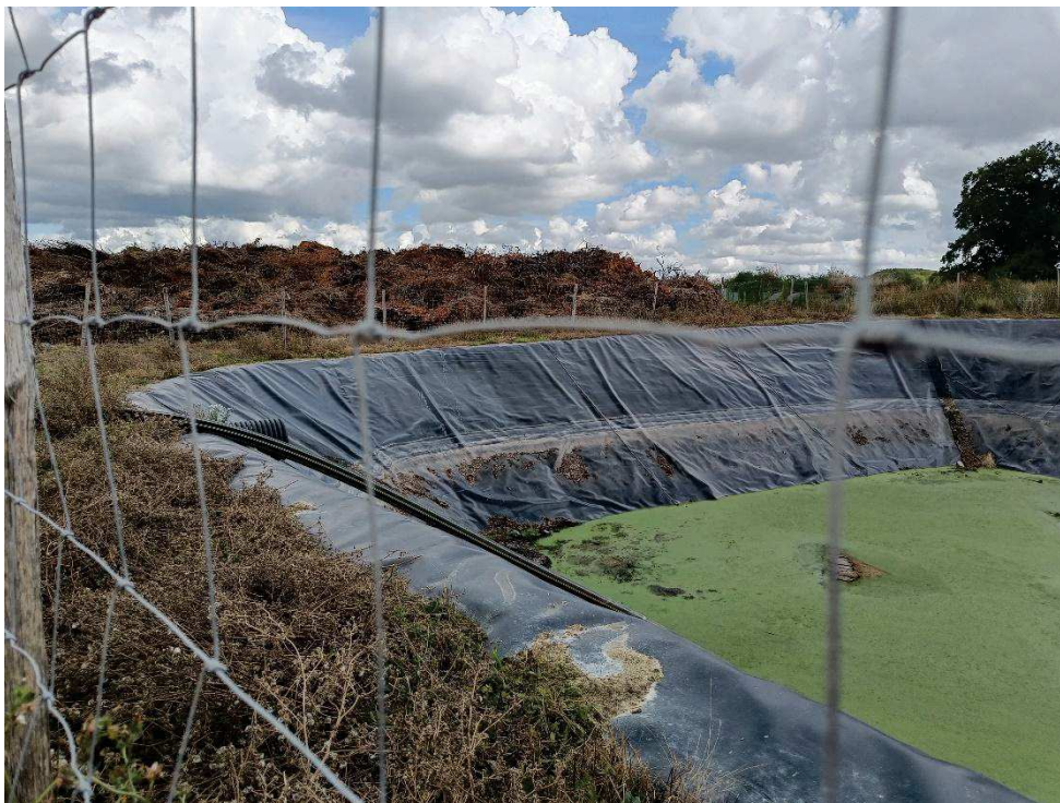
Figure 10 : Lagune de 2 000 m 3 ; la partie basse de la canalisation noire représente la hauteur maximale de stockage des eaux récupérées, le volume au deçà correspond à la rétention des eaux d'incendie du compostage
