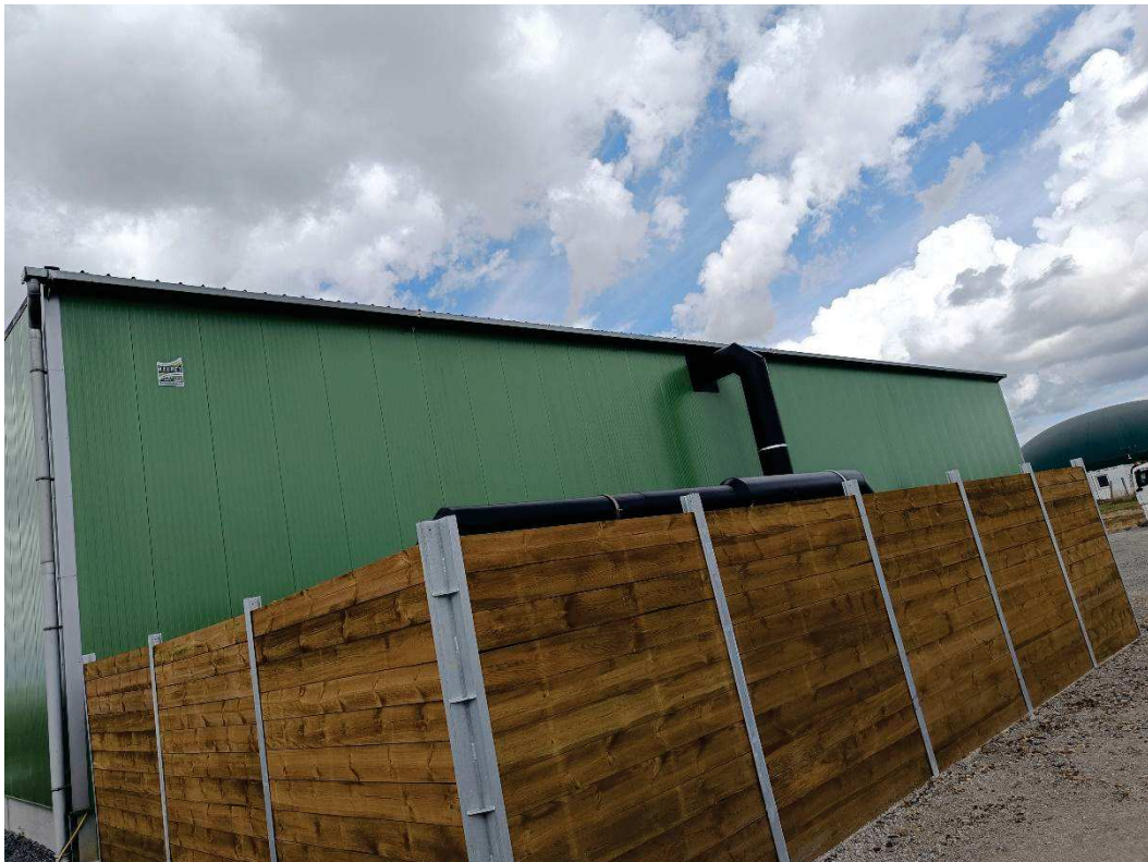
Figure 7 : Caisson du biofiltre avec visualisation sur les canalisations extérieures
