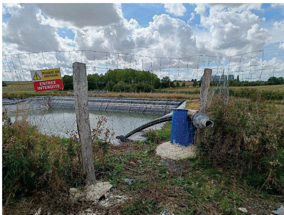
Figure 13 : Lagune de 4 000 m 3 : poste de pompage pour les pompiers
