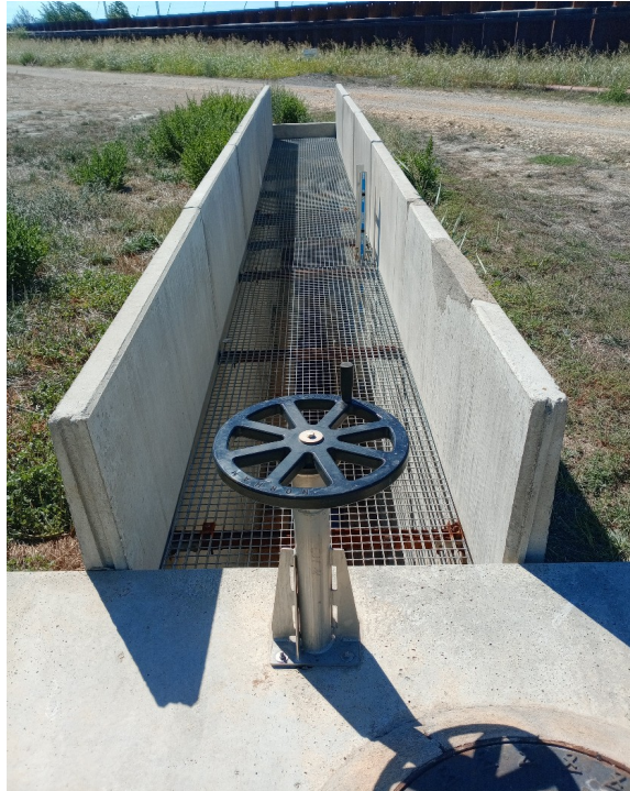
Photographie 3 : ouvrage hydraulique 11 (fermé mais non étanche) et canal de comptage
