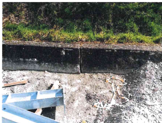
Fissure dans la bordure
