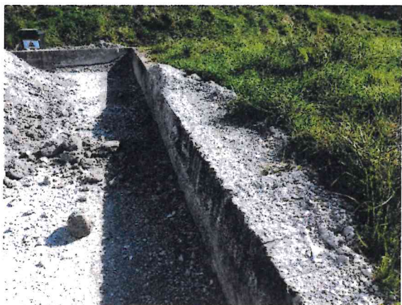
Dépôt de mâchefer au-delà de la bordure
