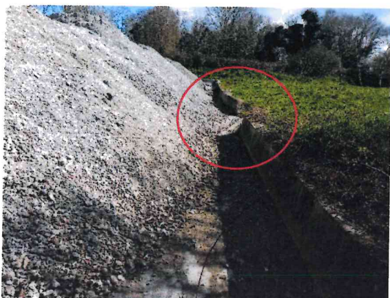
Interruption de la bordure de la plateforme
