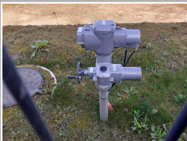
By-pass automatique infiltration/confinement
