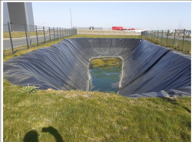
Noue rétention des eaux pluviales de voirie avec séparateur à hydrocarbures
