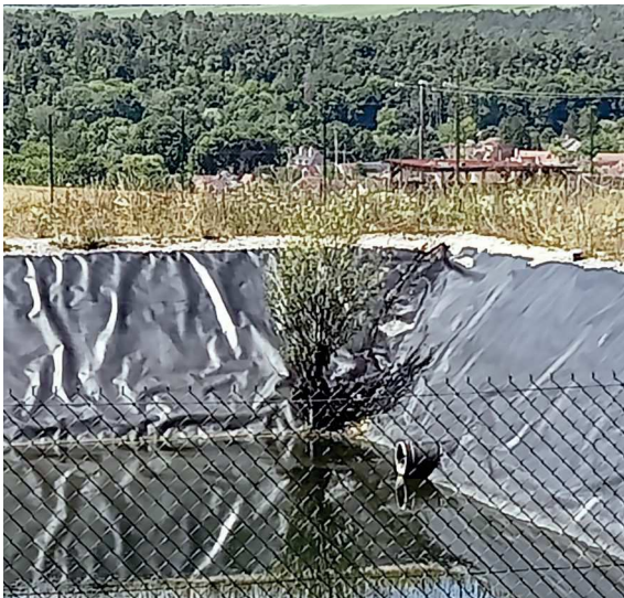
Figure 8: Arbuste compromettant l'étanchéité du bassin de rétention n°4 OUEST
