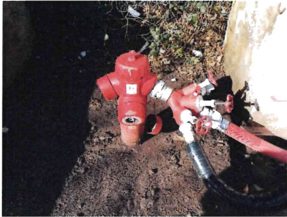
Nouveau poteau incendie normalisé
