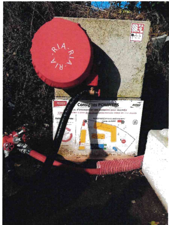
Nouveau robinet d'incendie armé (RIA)
