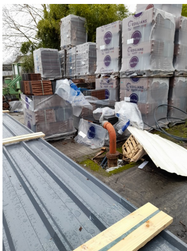
Plate-forme d'accès au puits privé défense incendie encombrée
